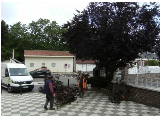
Abattage des arbres près de l'église et de l'école, leur développement occasionnant des dégâts aux bâtiments.
