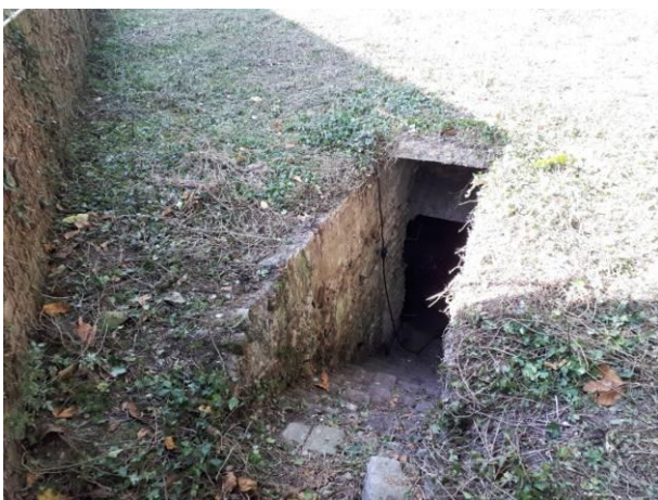
Monsieur le Maire, accompagné de Monsieur et Madame BERNARD, arrive à l'entrée du souterrain.
