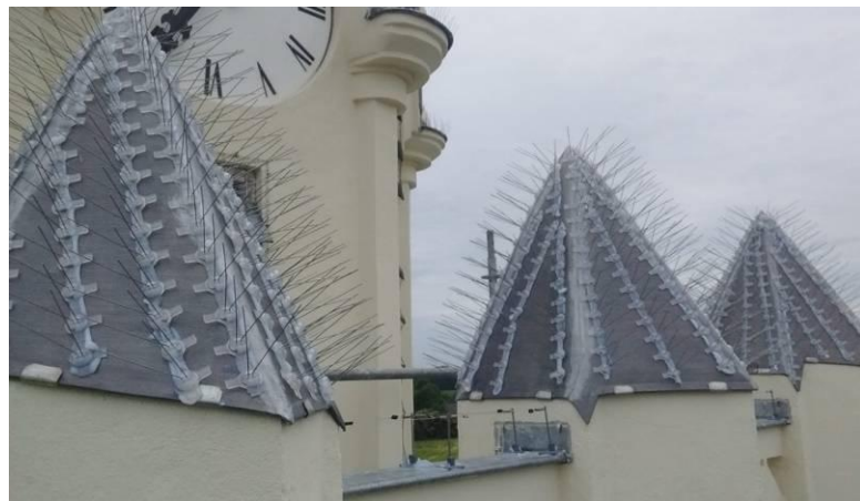
Tous les éléments en béton ont été recouverts par une protection en plomb et zinc avec un dispositif anti-pigeons
