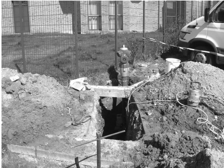
Remplacement de la bouche d'incendie rue de Boiry face à la gendarmerie.
