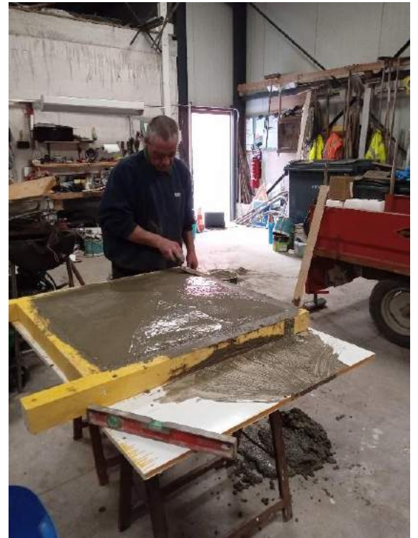
Coulage des couvre pilasses de la cour des écoles dans nos ateliers.
