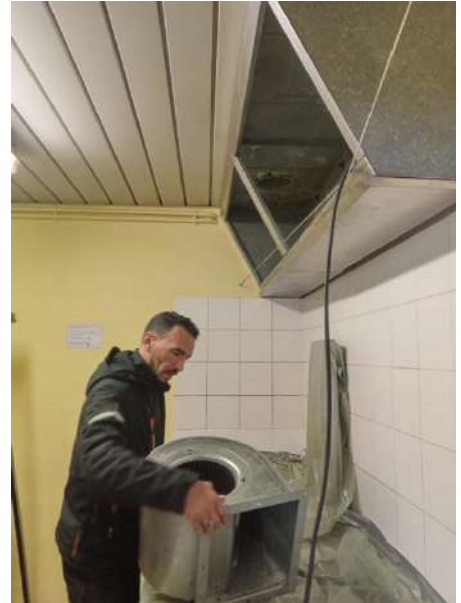
Entretien des équipements de chauffe et de la hotte aspirante aux cuisines
