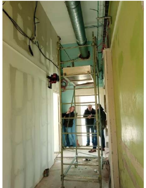
Montage d'une nouvelle installation électrique et d'une ventilation contrôlée avec détecteur de CO2
