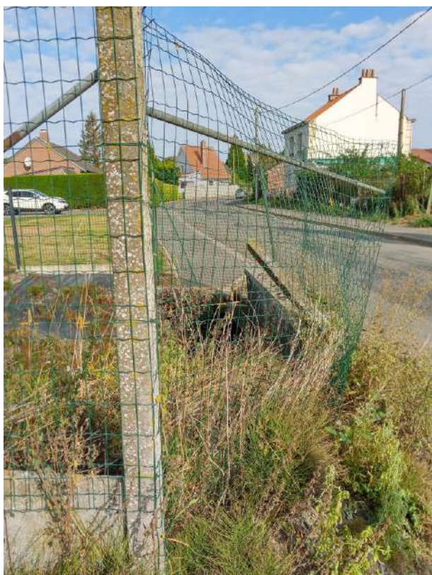
Accident 29/08/2022 Rue d'Hendecourt
