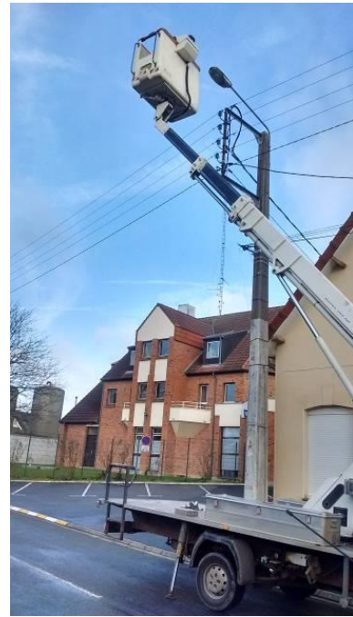
Entretien de l'éclairage public
