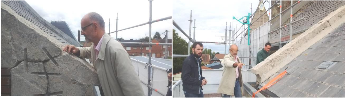
Pose de nouvelles armatures en inox et scellement à la résine sous la direction de l'architecte Eric BARIOL
