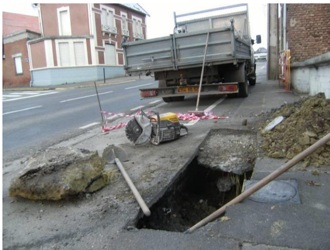
Effondrement d'une sape à proximité de la canalisation de gaz, rue André Mercier
