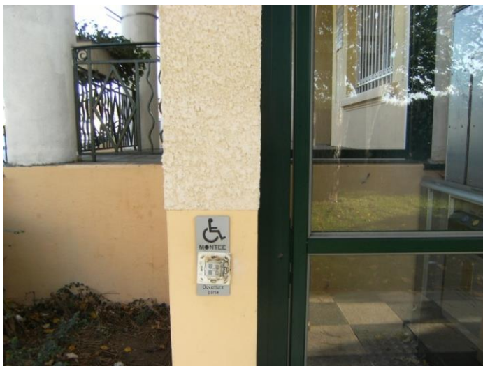
Incendie volontaire des commandes de l'ascenseur PMR le 31/10/2019
