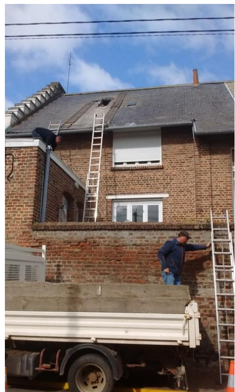
Travaux de couverture suite aux tempêtes, effondrement de la souche de cheminée du logement locatif.
