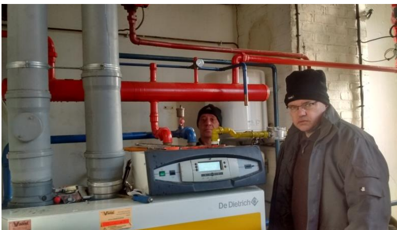
Chaufferie : entretien du circuit de circulation d'eau
