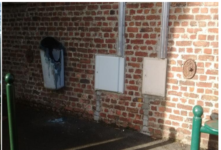
Feu de poubelle (31/10/2019) sous la mairie, près des coffrets de gaz le 31/10/2019
