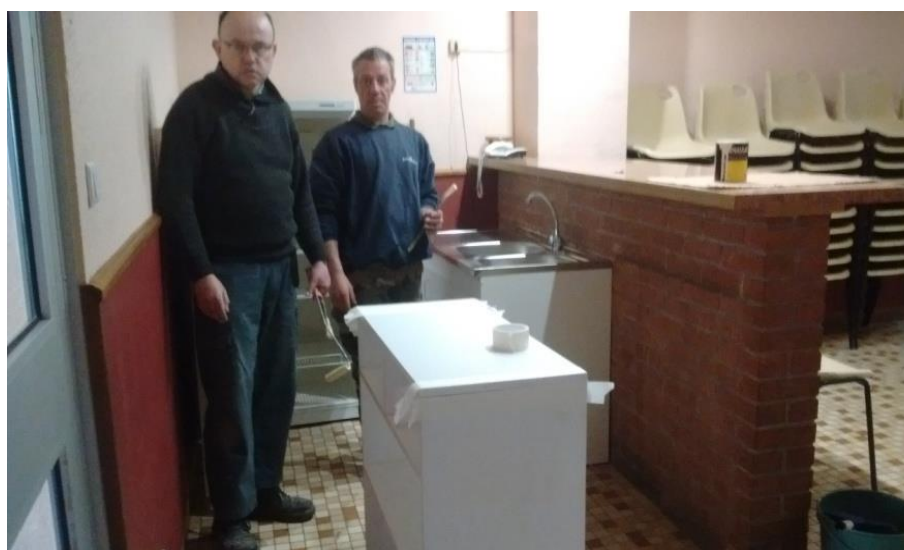
Au niveau du bar, changement du mobilier (rangement) ainsi que de l'évier.
