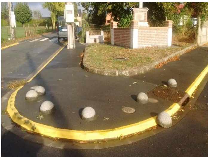
Dégradation des plots au Calvaire le 28/09/2019
