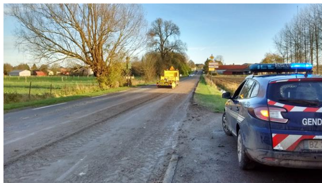
Perte de gravats d'un camion de chantier (23/11/2015)
