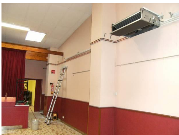
La fin des travaux de l'extension de la salle polyvalente a concerné la pose de sanitaire et d'un aérotherme pour le chauffage.
